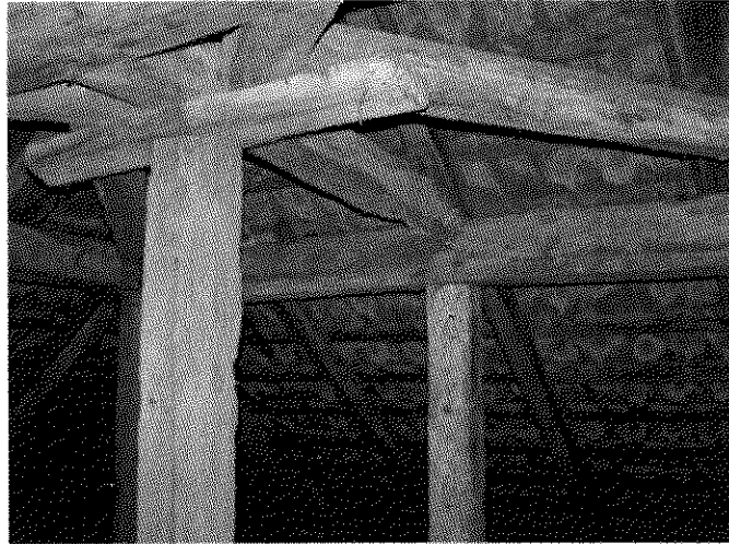
7. ábra Az állószerkezet fertőzött elemei
